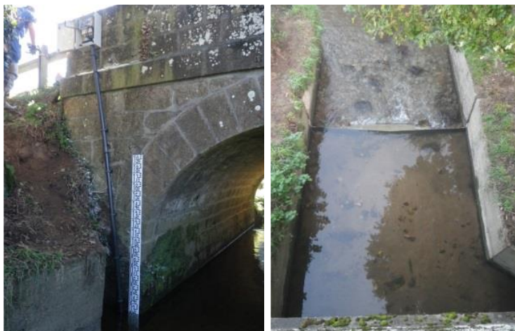
Figure 4 : station hydrométrique du Ris avec contrôle et seuil artificiels (déversoir en V) - EPAB, 2015
